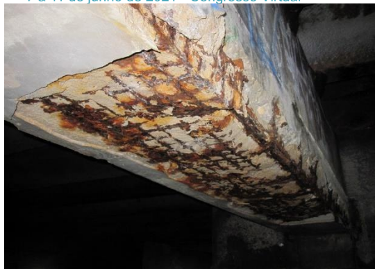
Fig. 1 Estrutura de Concreto com Reincidência de Corrosão após Serviços de Reparos
