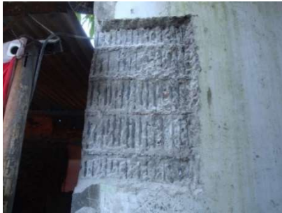
a) Pilar com camada de cobrimento removida.
