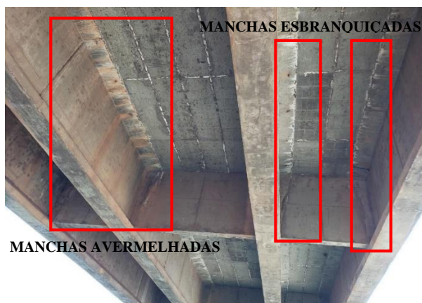
Figura 6 – Vigas longarinas, transversinas e laje com manchas avermelhadas (indício de corrosão) e esbranquiçadas (indício de lixiviação).
