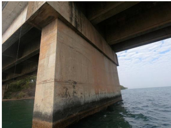
Figura 8 – Pilar manchado e desgastado na zona de transição com o nível de água.
