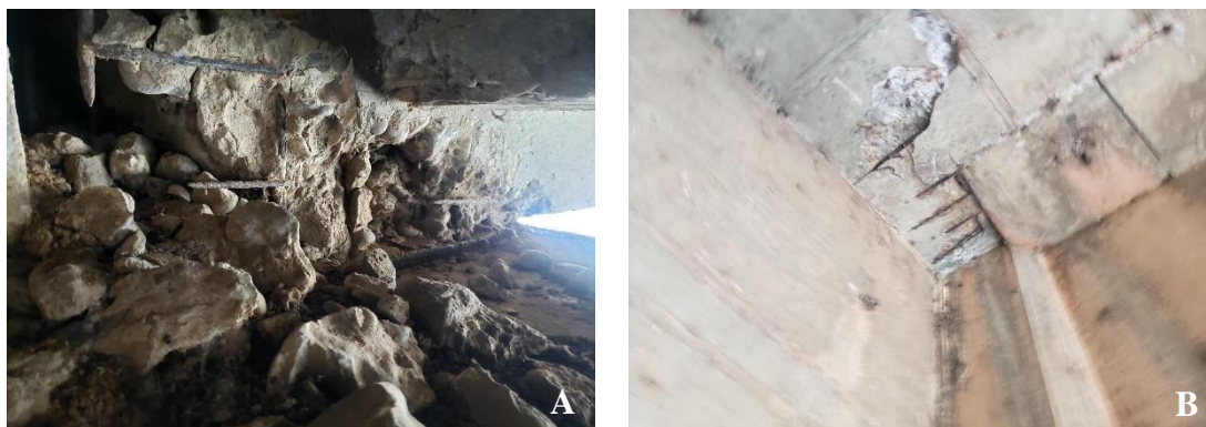
Figura 7 – Exemplos de anomalias encontradas nos elementos da superestrutura. A – Viga longarina com armaduras expostas por falha de concretagem. B – Laje com armaduras expostas com indícios de corrosão (manchamento).
