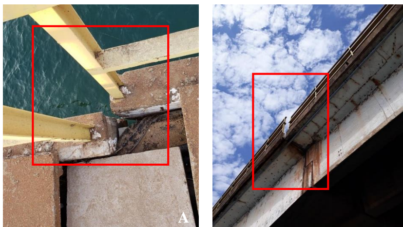
Figura 3 – Deslocamento na ponte devido a um acidente com uma embarcação. A – Vista superior. B – Vista inferior.
