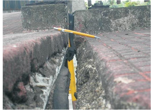
Figura 11 – Detalhe do desnível entre a rampa de acesso e o passeio principal
