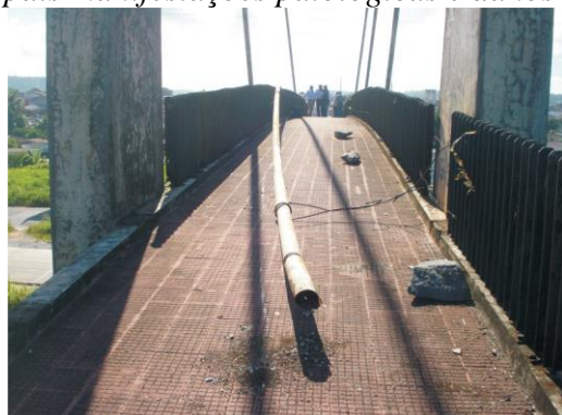
Figura 8 – Vista superior da rampa apresentando estai rompido e parte de guarda-corpo metálico danificado
