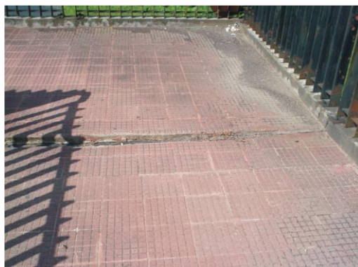
Figura 17 – Junta danificada entre a rampa de acesso e o passeio principal
