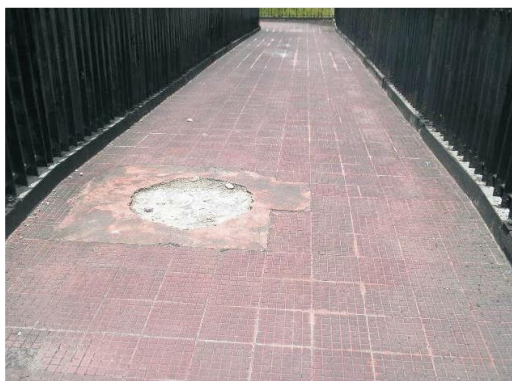
Figura 16 – Dano no pavimento do passeio da passarela
