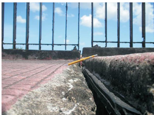
Figura 18 – Desnível na junta entre a rampa de acesso e o passeio principal
