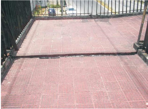
Figura 10 – Junta danificada e rampa desnivelada
