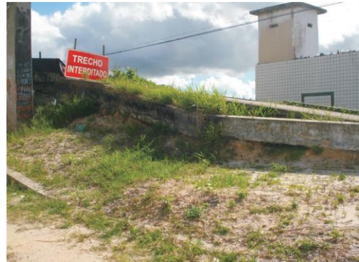
Figura 13 – Vista lateral do aterro de acesso com acentuada deformação
