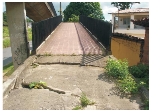
Figura 15 – Vista do aterro de acesso apresentando rachaduras decorrentes de recalque
