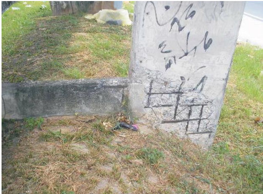
Figura 12 – Pilar da rampa de acesso com armaduras expostas e deslocamento do concreto
