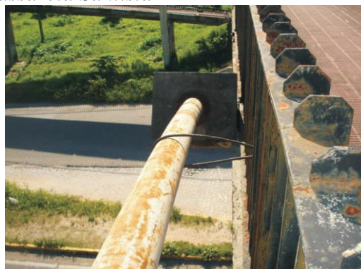
Figura 9 – Detalhe da ancoragem do estai rompido
