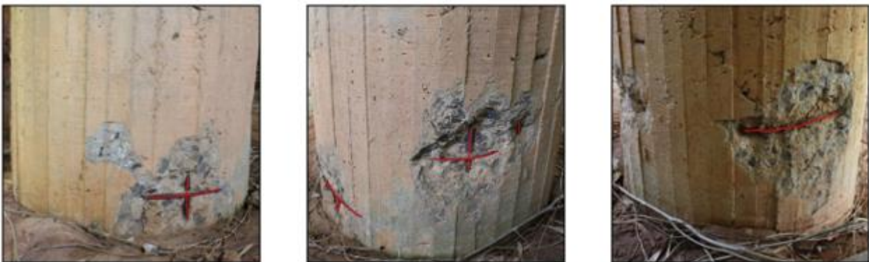
Figura 6. Deslocamento do concreto e armaduras expostas na base do pilar.
