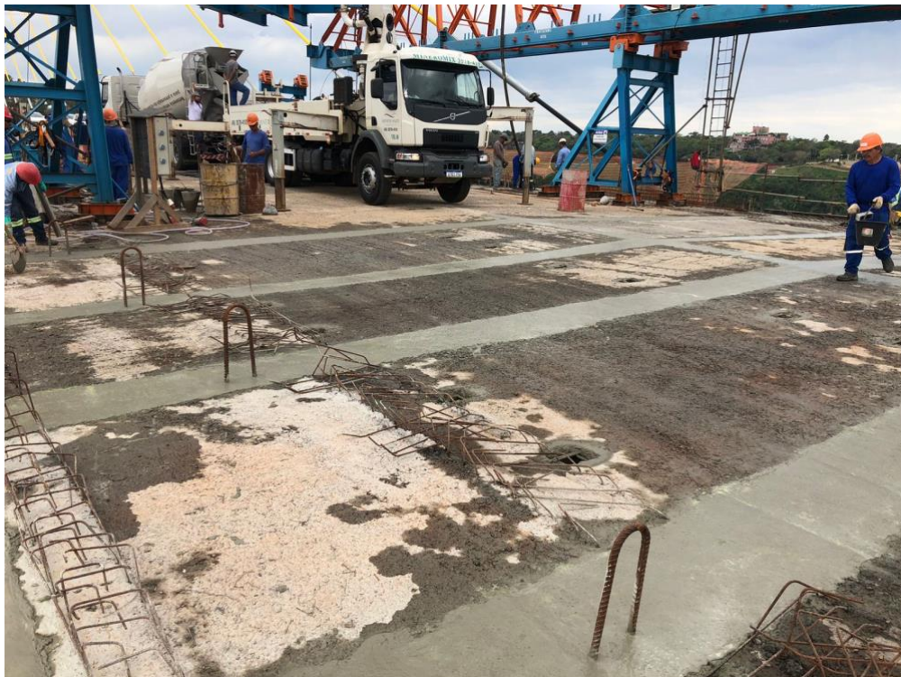
Figura 9 – lajes pré-moldadas e grauteamento no tabuleiro em processo de cura (fonte ANTW Engenharia).
