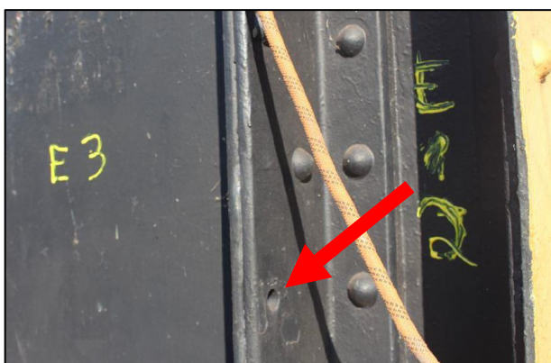
Figura 10 – Falha em ligação rebitada. Fonte: próprio autor.
