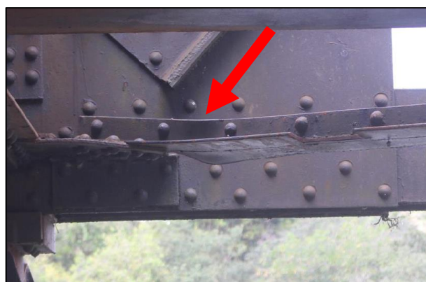
Figura 11 – Peça deformada. Fonte: próprio autor.
