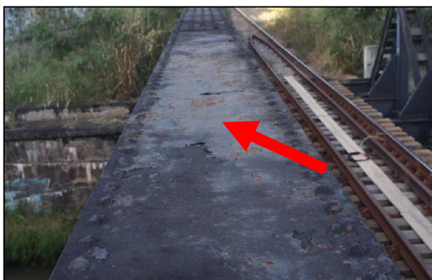
Figura 8 – Falha na pintura de proteção. Fonte: próprio autor.
