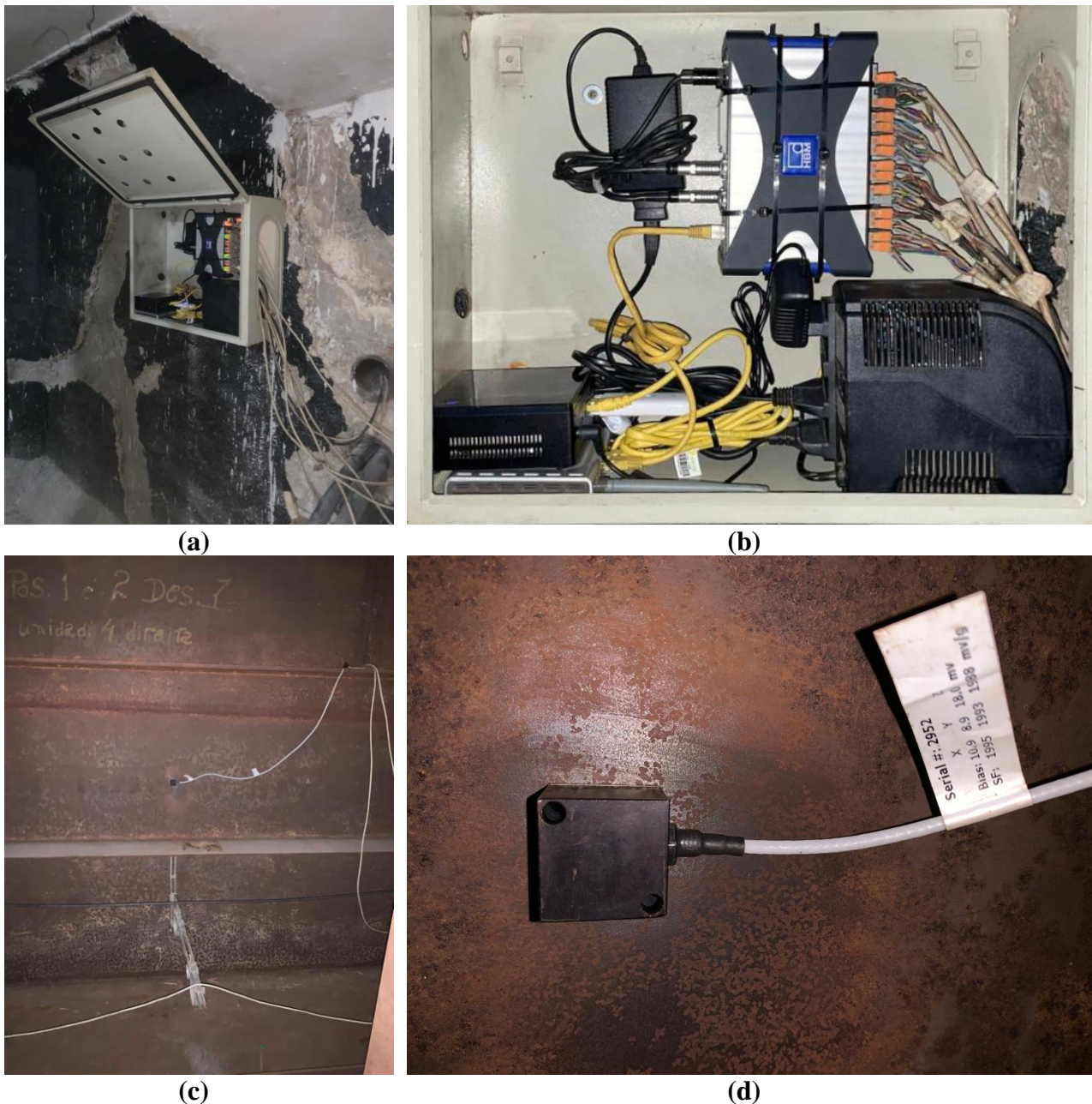
Figura 11 – (a) Localização do sistema de aquisição de dados; (b) Disposição dos equipamentos do sistema de aquisição de dados (c) Acelerômetro fixado na alma externa do caixão metálico (d) Detalhe do acelerômetro 2g.
