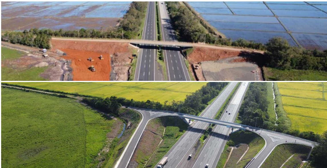
Figura 16. Viaduto Localizado no km 32+100 (Santo Antônio da Patrulha) durante a Construção (Em Cima) e Após a Conclusão (Embaixo)
