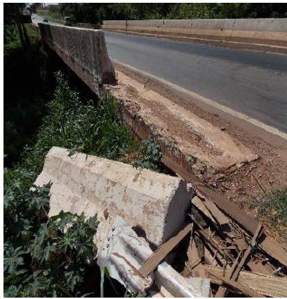
Figura 11 - Guarda-rodas ou barreira destruídos (SGO, 2020).
