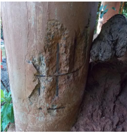
Figura 4 – Deslocamento do concreto com armadura exposta (SGO, 2020).
