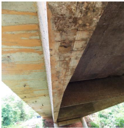
Figura 5 – Armadura sem cobrimento (SGO, 2020).
