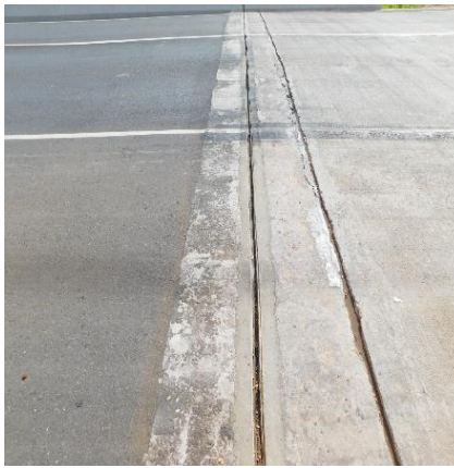
Figura 10 - Junta danificada ou inexistente ou expelida (SGO, 2020).
