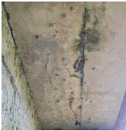
Figura 8 – Fissura profunda fina e infiltração no concreto (SGO, 2020).
