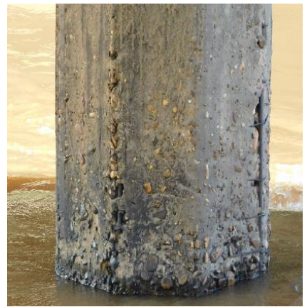
Figura 6 – Concreto desagregado com armadura exposta e oxidada (SGO, 2020).
