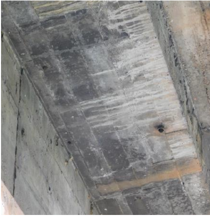
Figura 1 – Lixiviação e mancha de carbonatação (SGO, 2020).
