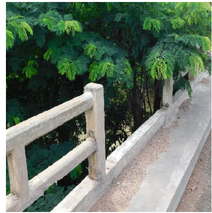
Figura 12 - Guarda-corpo destruído (SGO, 2020).
