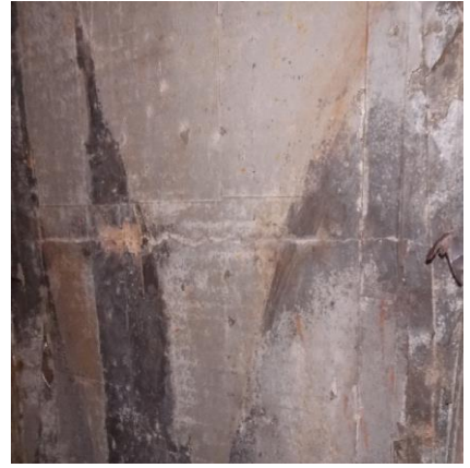
Figura 3 – Fissura superficial (SGO, 2020).
