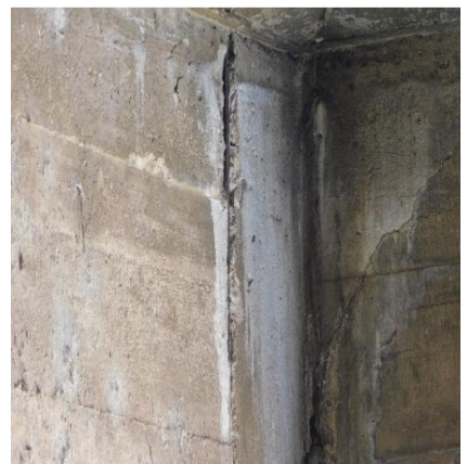
Figura 9 – Fissura profunda aberta (SGO, 2020).
