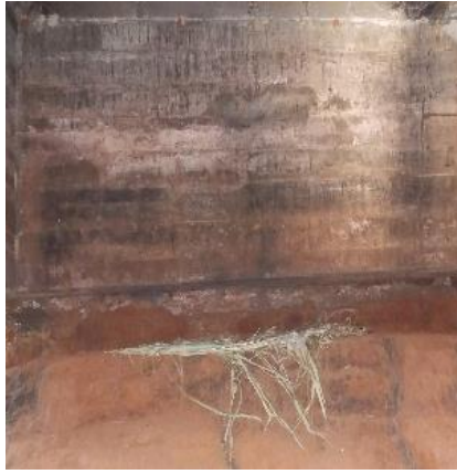
Figura 2 – Infiltração do concreto (SGO, 2020).
