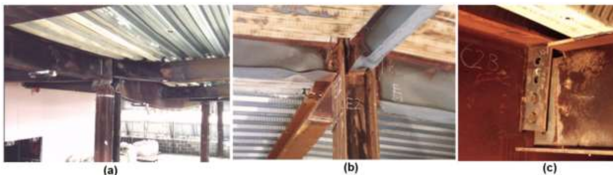
Figura 5: (a) vigas e pilares metálicos submetidos a temperatura de até 750 °C por aquecimento a gás, (b) estrutura submetida a aquecimento por queima de madeira, com temperatura chegando a 1000 °C e (c) falha na conexão da estrutura ocorridas pela alta temperatura no qual a peça foi submetida. – Fonte: Lamont, 2001 – adaptado.
