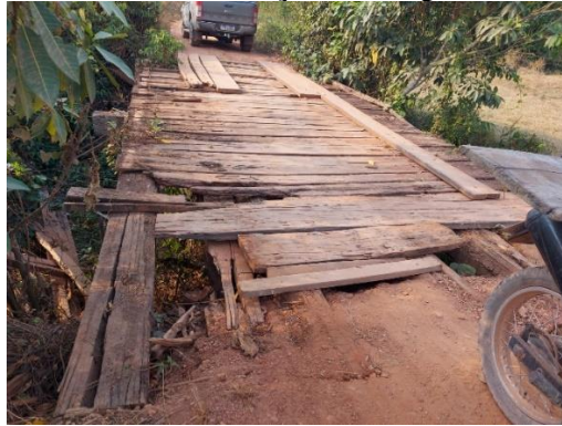
Figura 6: Estado de conservação da 3° ponte da C8- Ponte F
