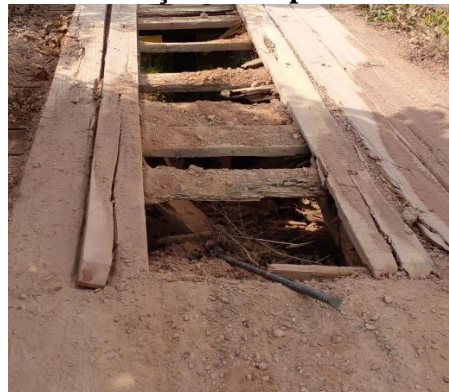
Figura 4: Estado de conservação da 2ª ponte Boa esperança - Ponte D
