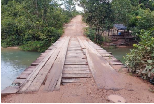
Figura 5: Estado de conservação da 2° ponte da PA 151 km22- Ponte E
