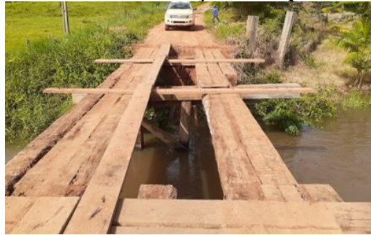
Figura 2: Estado de conservação da 2ª ponte C4- Ponte B
