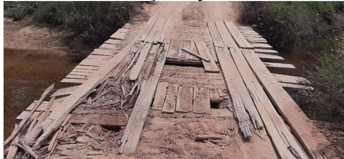
Figura 11: Estado de conservação da ponte vicinal Deodata- Ponte K
