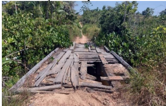
Figura 8: Estado de conservação da 4° ponte da vila Boa Esperança- Ponte H
