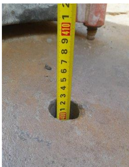
Figura 6 – Furos de aproximadamente 4 metros na laje (Fonte: acervo digital da Gmaia)
