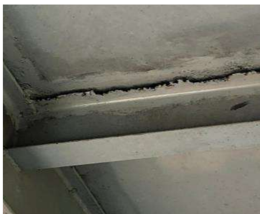
Figura 10 – Deterioração da estrutura.
