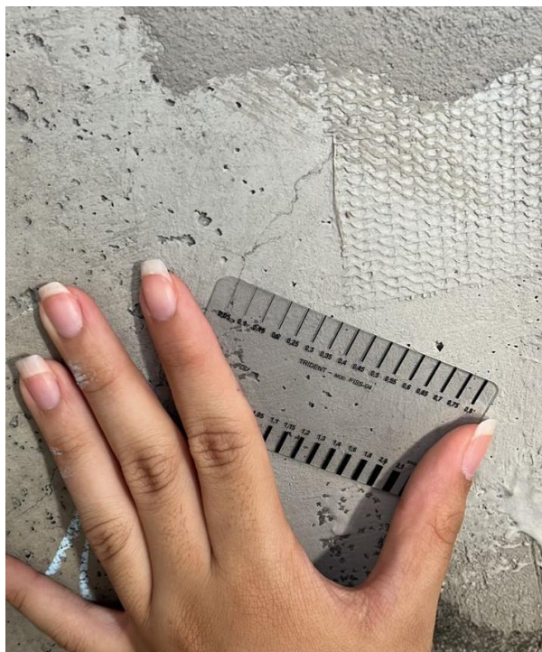
Figura 9: Fissura apresentada antes da concepção do acabamento em vão de janela (Autor, 2025).
