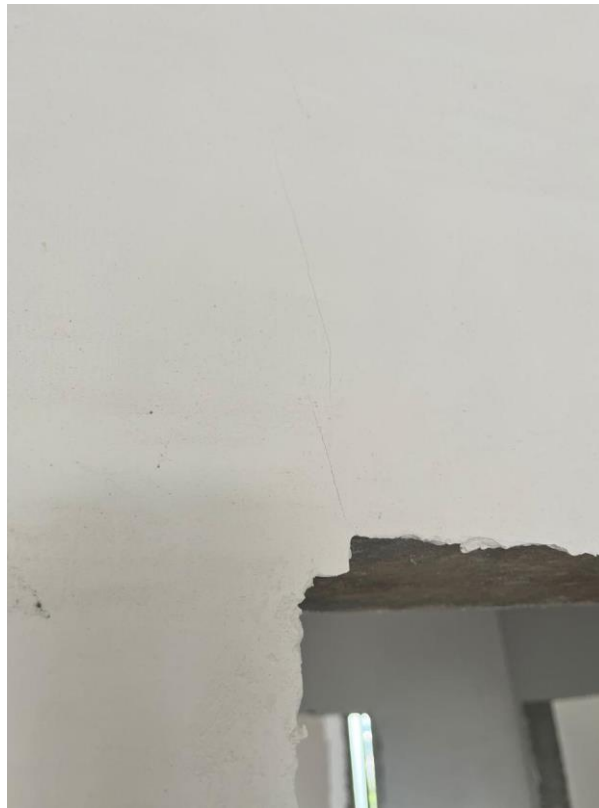
Figura 8: Fissura linear no vão da porta, ainda mais aparente devido ao acabamento (Autor, 2025).
