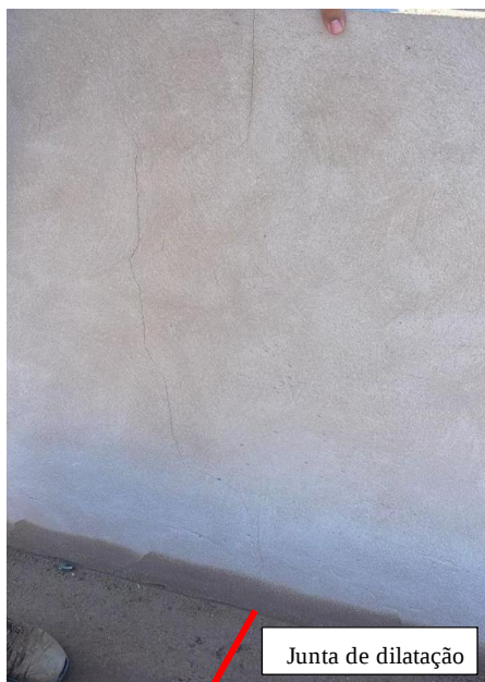
Figura 14 – Fissura na alvenaria do muro de divisa da piscina (Autor, 2025).
