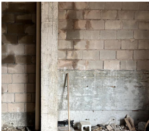
Figura 7 – Parede da área gourmet sem previsão de junta de dilatação vertical na etapa de estrutura (Autor, 2025).
