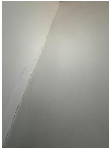
Figura 12 – Fissura reaparecendo na parede área gourmet após primeiro tratamento (Autor, 2025).
