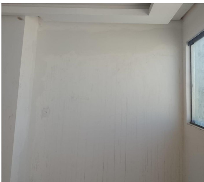
Figura 11 – Parede área gourmet após primeiro tratamento (Autor, 2025).
