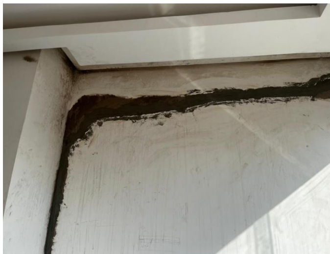
Figura 9 – Parede da área gourmet apresentando fissura entre o pilar e bloco de vedação, antes de receber o tratamento (Autor, 2025).
