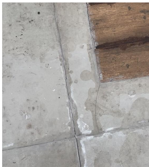
Figura 8 – Deck da piscina apresentando deslocamento do revestimento cerâmico e falhas no rejunte (Autor, 2025).
