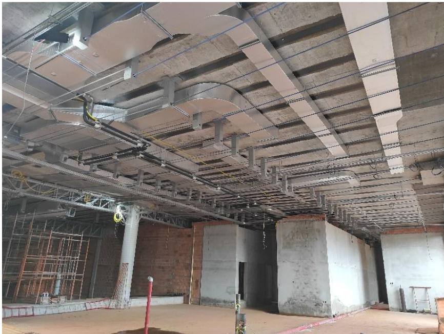
Figura 1 – Foto dos cabos e desviadores para protensão externa da laje
